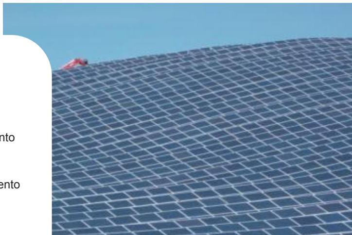
Parco fotovoltaico di 18,2 MWp a Les Mées, nel Sud della Francia.
